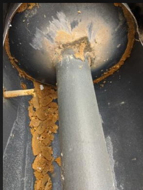
Calentador de agua sin IPS instalado
