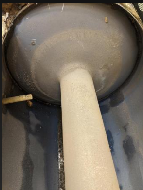
Calentador de agua con IPS instalado
